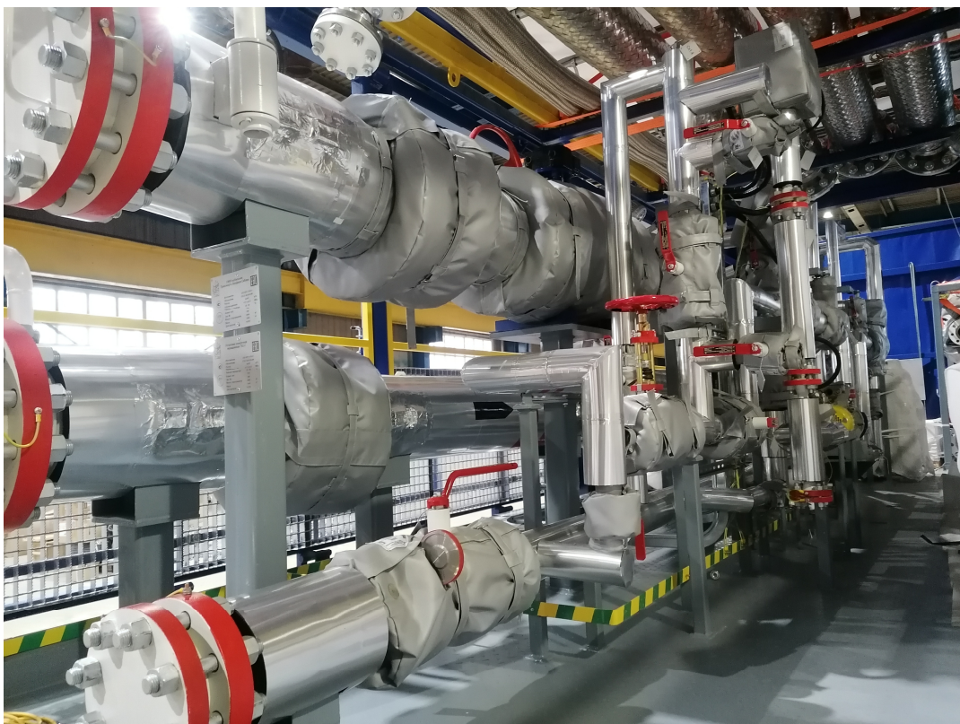
Рисунок 1 – Общий вид установки
