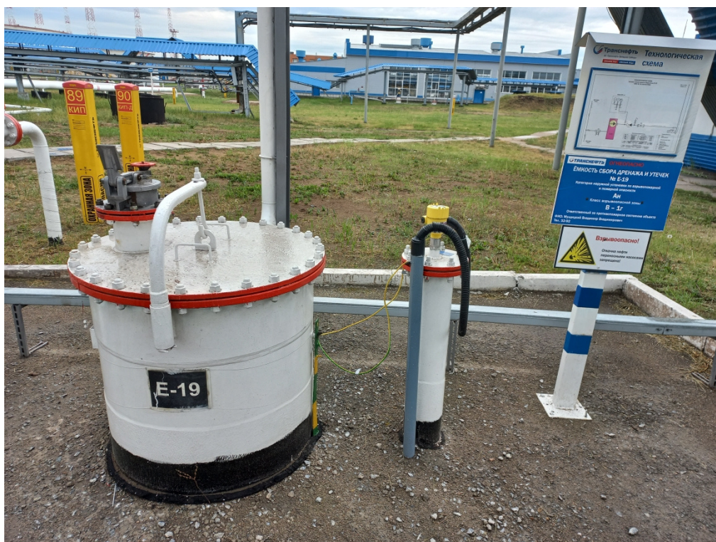
Рисунок 3 – Горловины и измерительный люк резервуара
