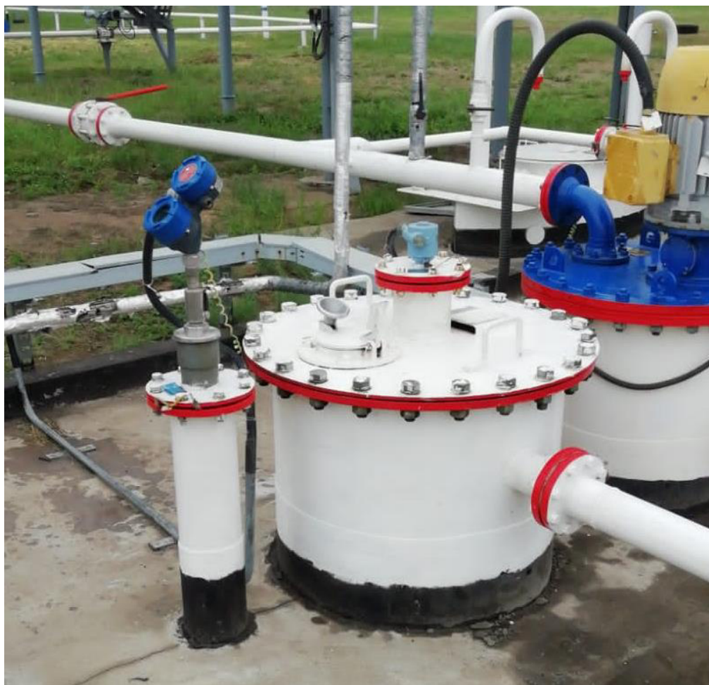
Рисунок 3 – Горловины и измерительный люк резервуара
