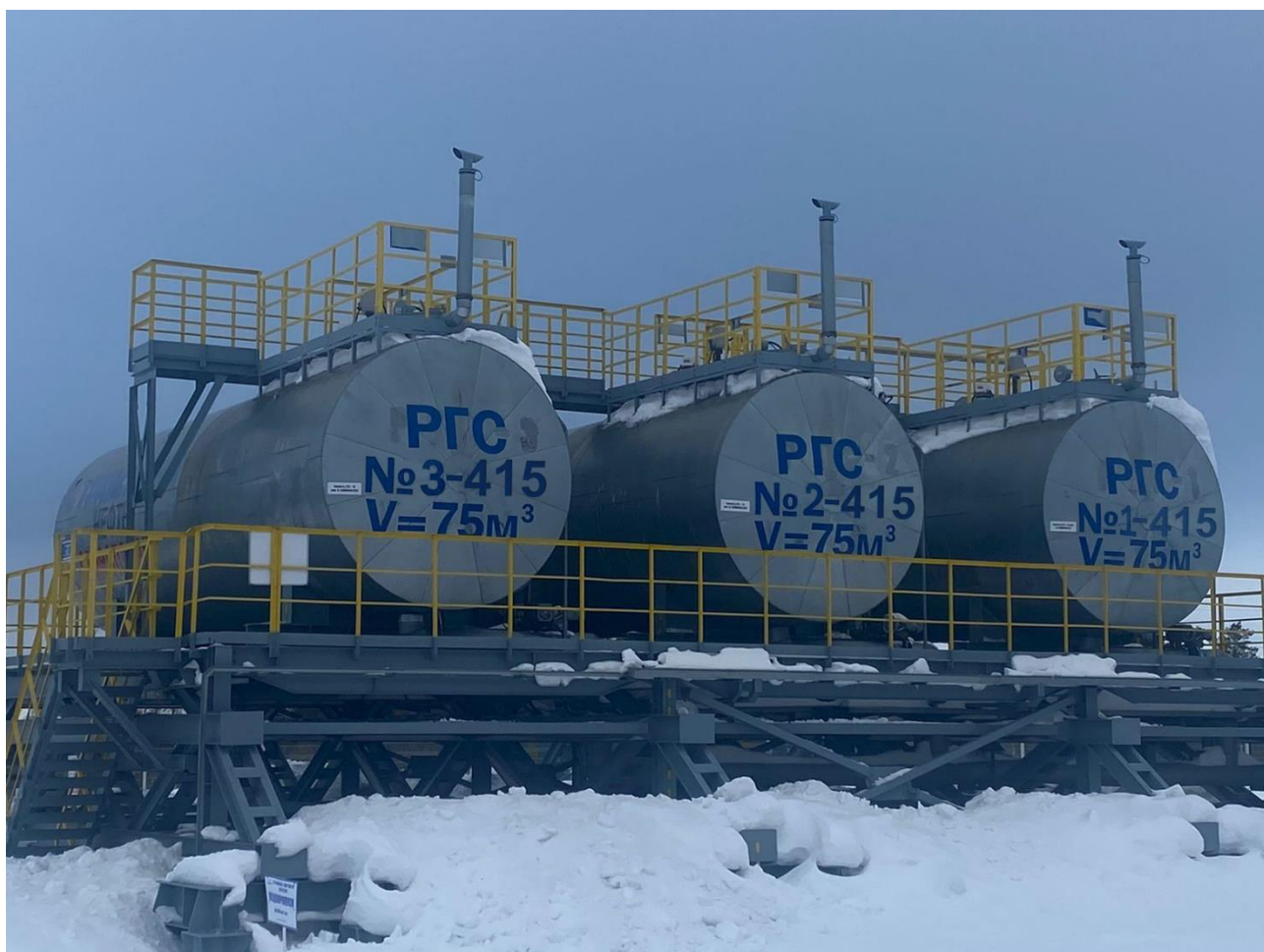
Рисунок 1 – Общий вид резервуаров РГС-75
