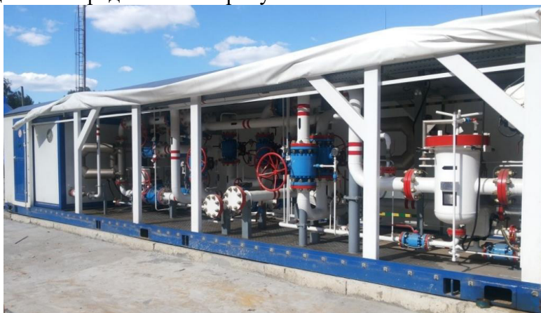
Рисунок 1 - Общий вид СИКН
