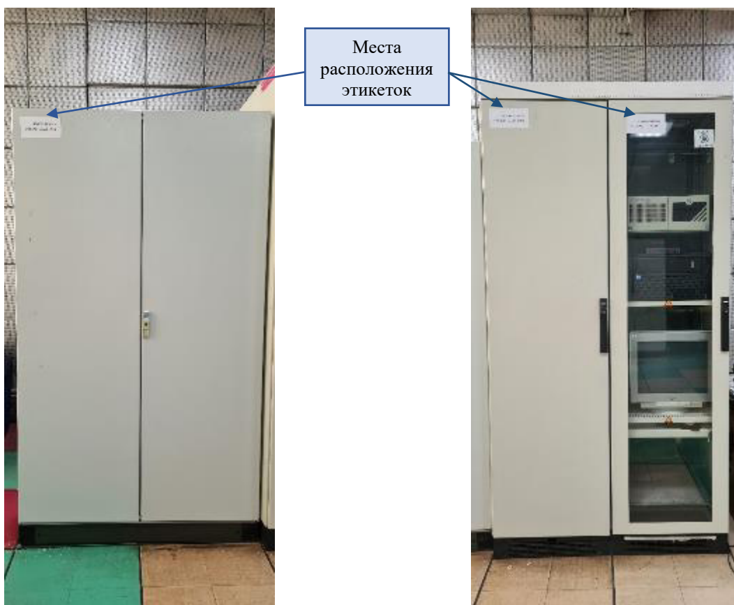
Рисунок 1 – Коммутационный шкаф. Вид внешний
