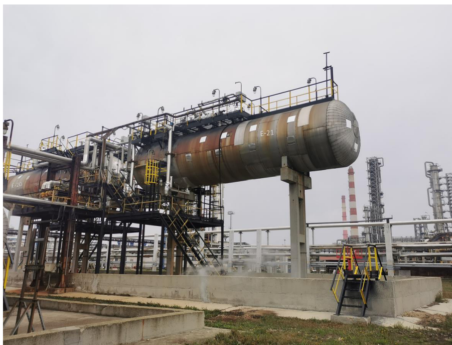
Рисунок 1 – Общий вид резервуаров РГС-100
