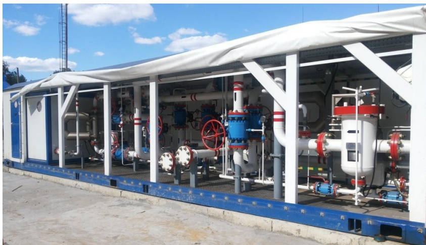
Рисунок 1 - Общий вид СИКН
