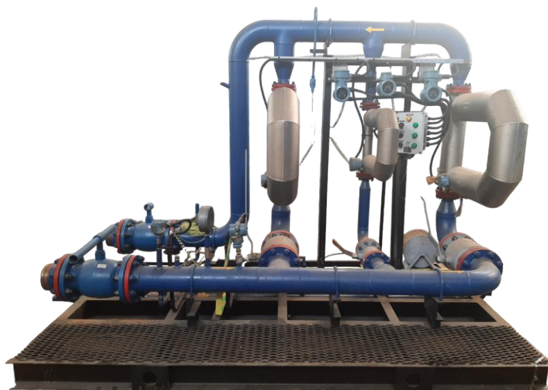
Рисунок 1 – Общий вид установки
