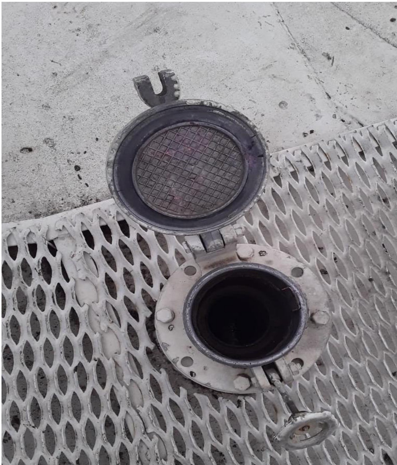
Рисунок 4 - Фотография горловины замерного люка резервуара РВСП-2000 заводской номер 24612
