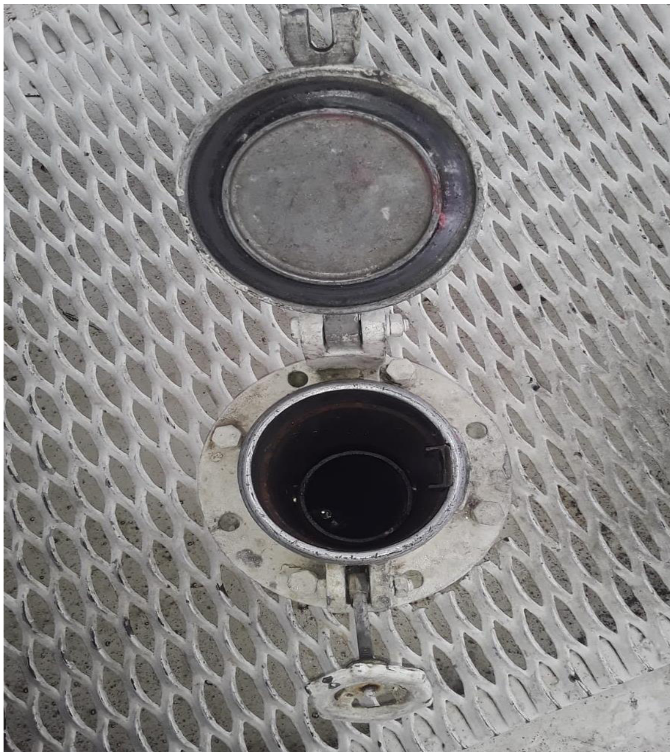
Рисунок 3 - Фотография горловины замерного люка резервуара РВСП-2000 заводской номер 24586
