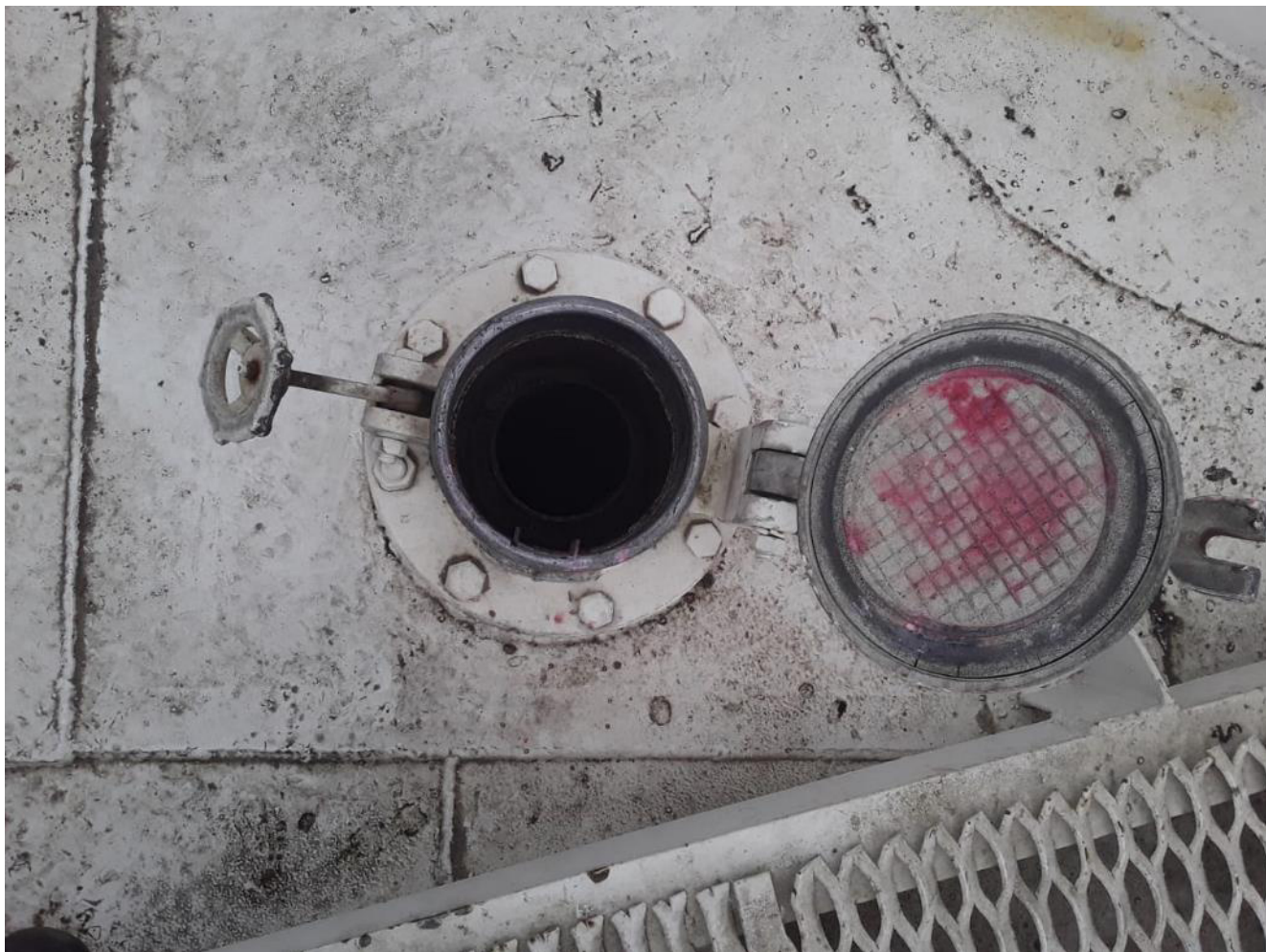
Рисунок 2 - Фотография горловины замерного люка резервуара РВСП - 2000 заводской номер 37
