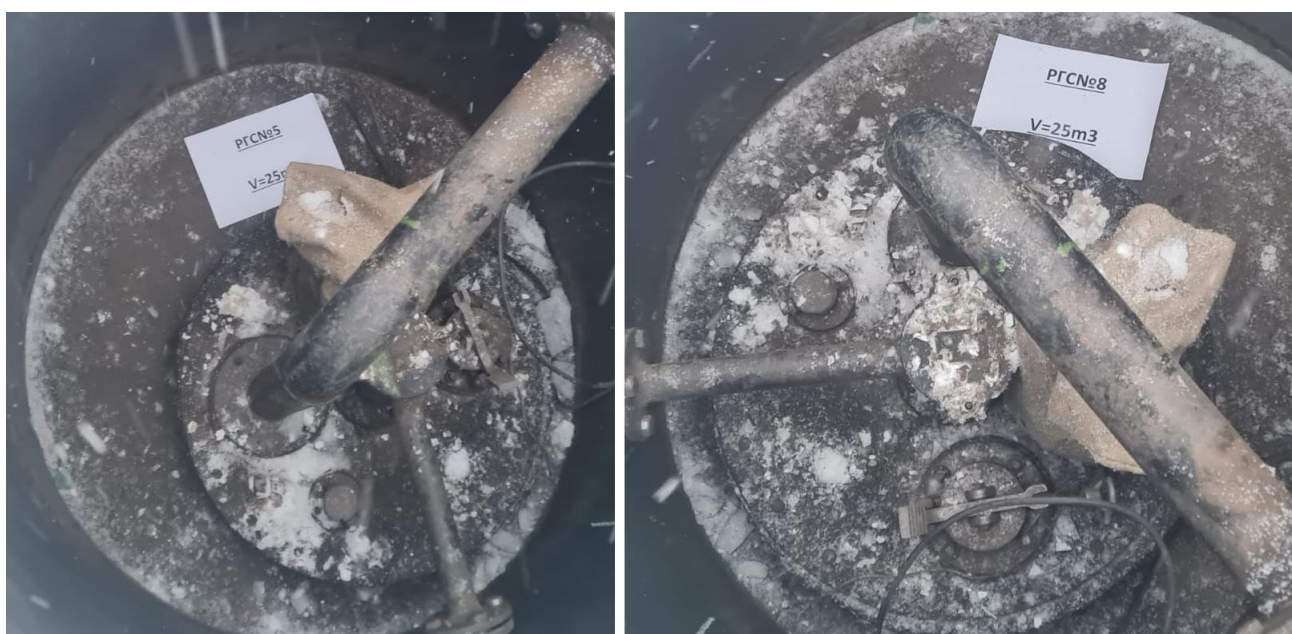
Рисунок 4 – Горловины резервуаров РГС-25 зав.№5, 8
