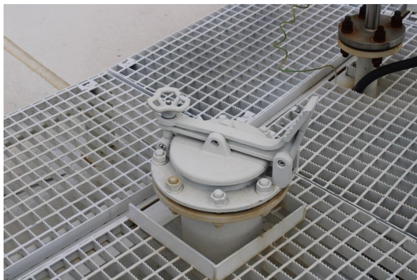
Рисунок 2 – Замерной люк резервуара
