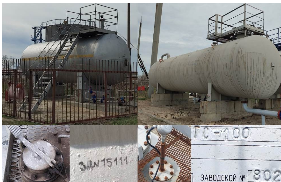
Рисунок 1 – Фотография общего вида резервуаров РГС-31 (№15111), РГС-100 (№802), горловин и заводских номеров
