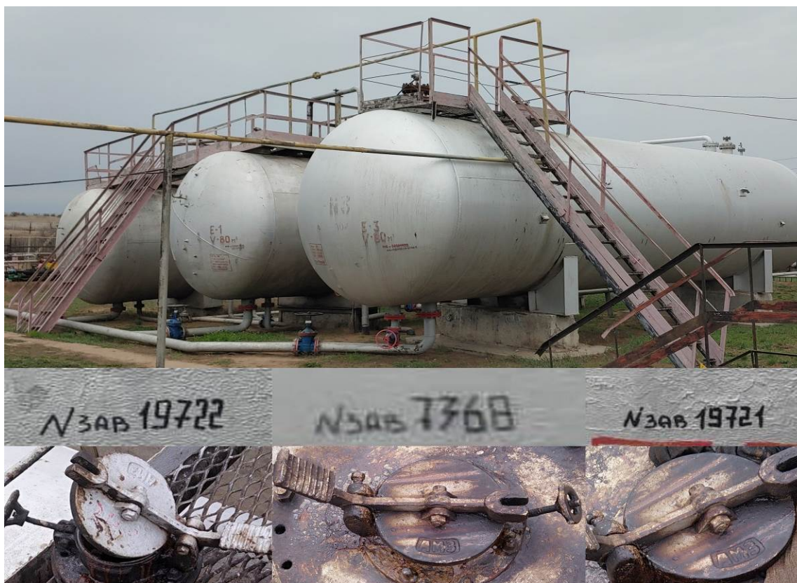
Рисунок 1 – Фотография общего вида резервуаров РГС-80, горловин и заводских номеров
