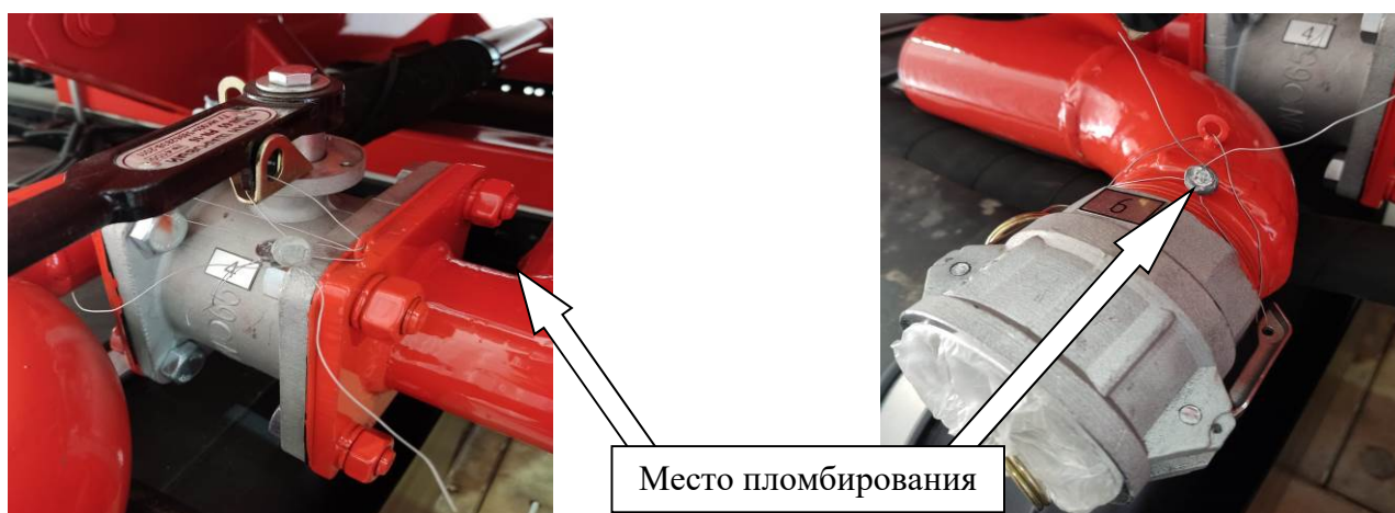
Рисунок 4 – Заглушка быстроразъёмного соединения, кран шаровый на трубопроводе
