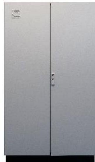
Рисунок 4 – Шкаф коммутационный АИИС ПД200. Вид общий
