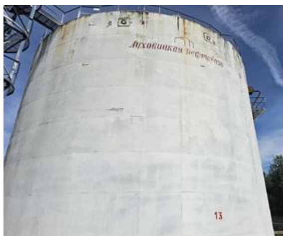
Рисунок 1 – Общий вид РВС-2000 зав.№13
