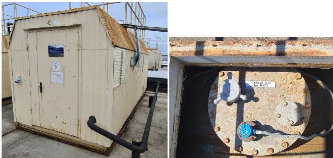
Рисунок 1 – Общий вид резервуара РГСН-10 зав.№ 075
