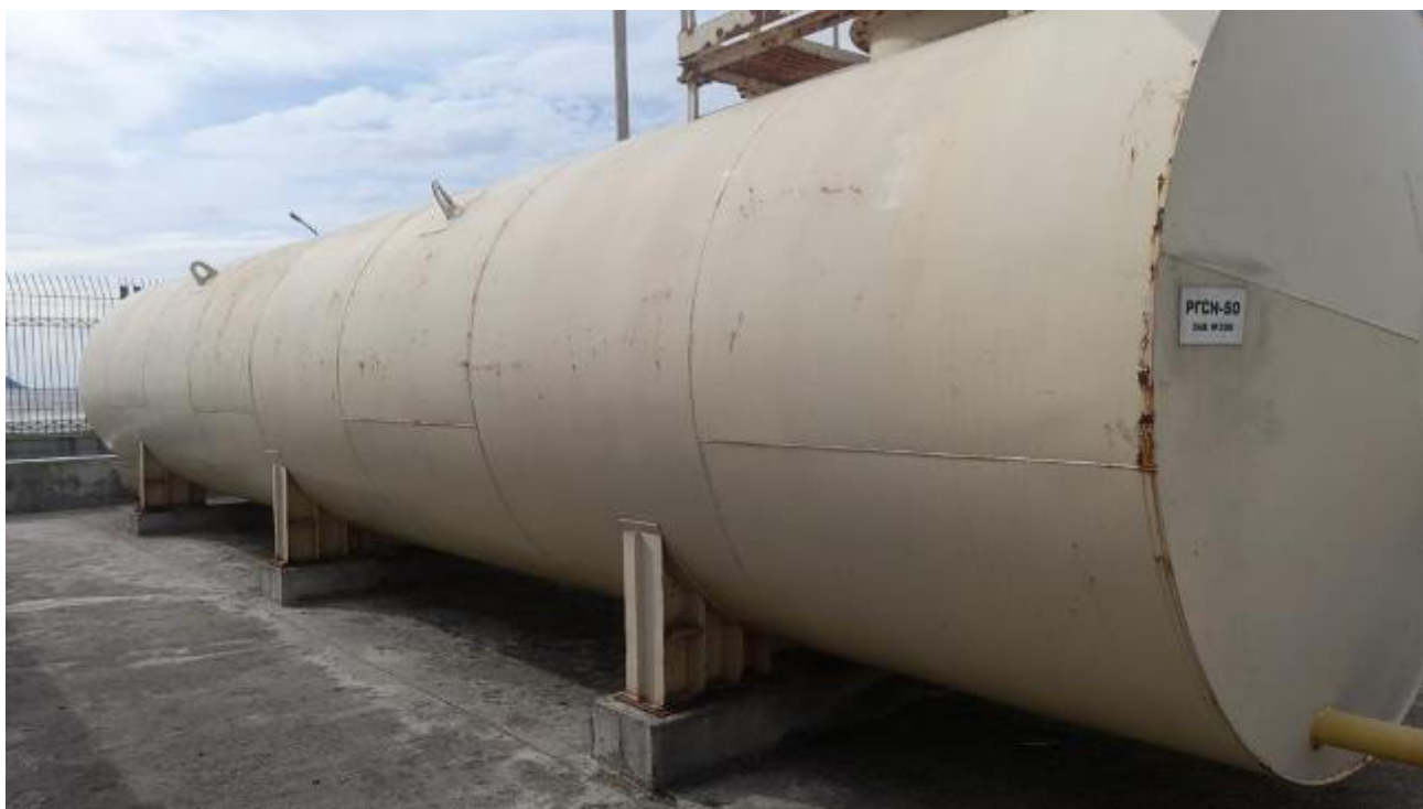
Рисунок 5 – Общий вид резервуара РГСН-50 зав.№ 236
