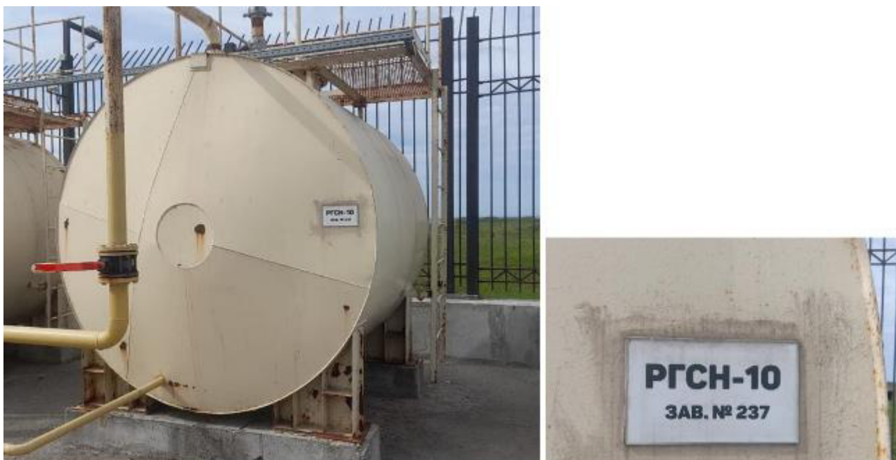
Рисунок 2 – Общий вид резервуара РГСН-10 зав.№ 237
