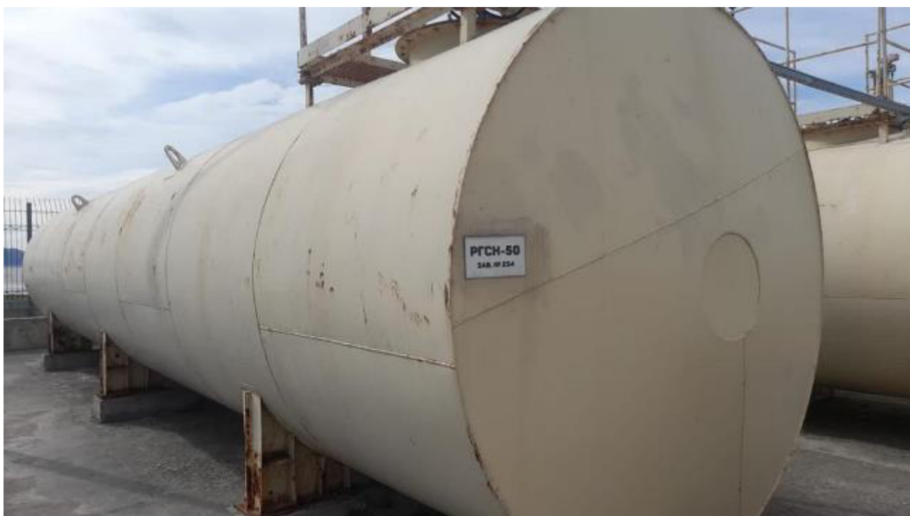
Рисунок 4 – Общий вид резервуара РГСН-50 зав.№ 234
