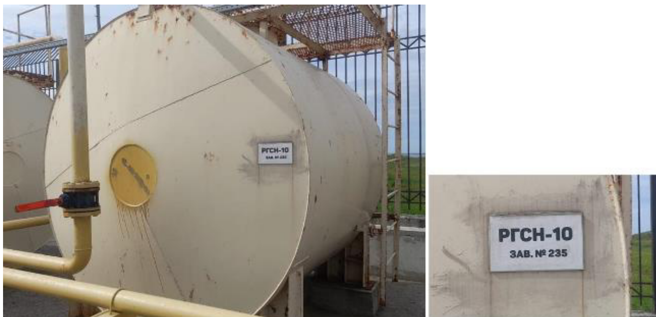
Рисунок 1 – Общий вид резервуара РГСН-10 зав.№ 235
