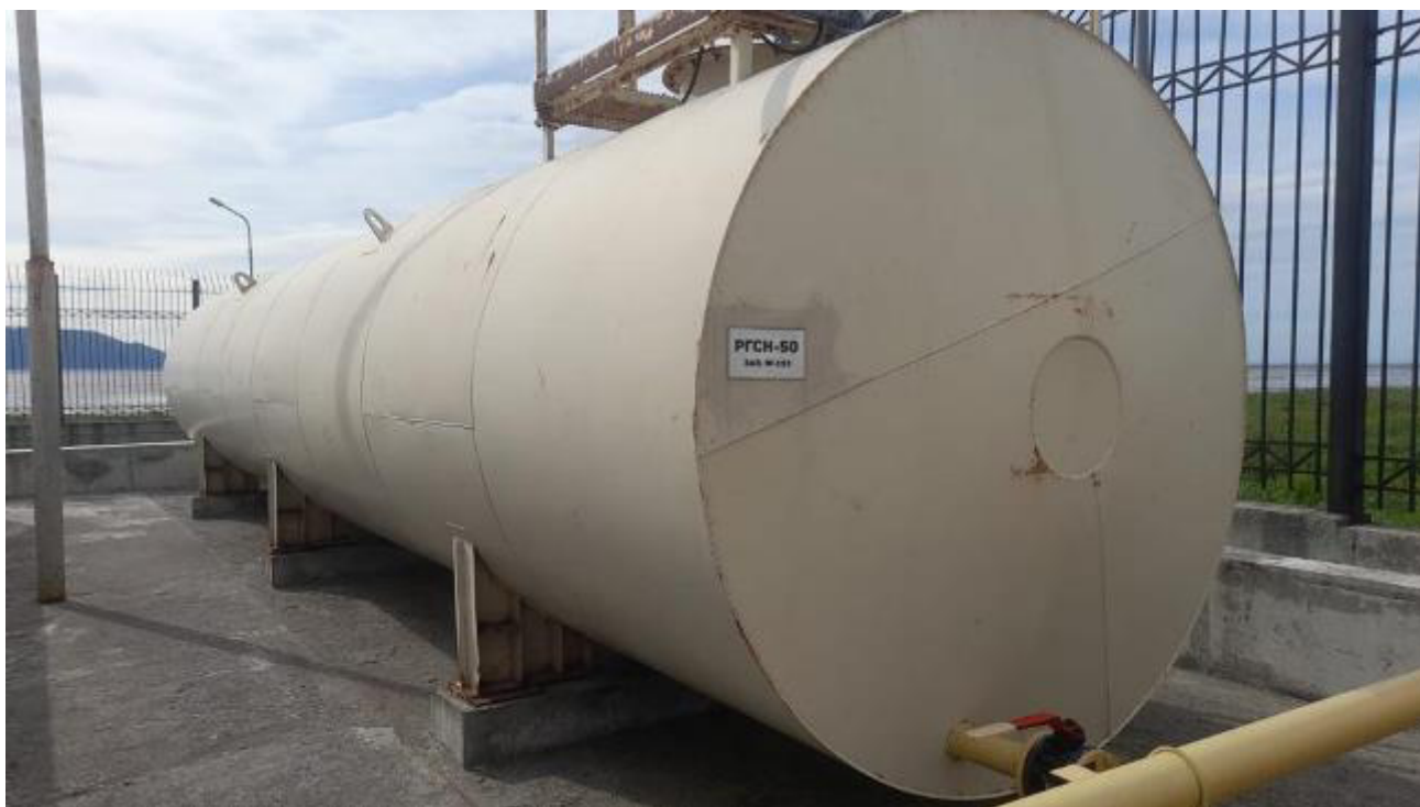
Рисунок 3 – Общий вид резервуара РГСН-50 зав.№ 233
