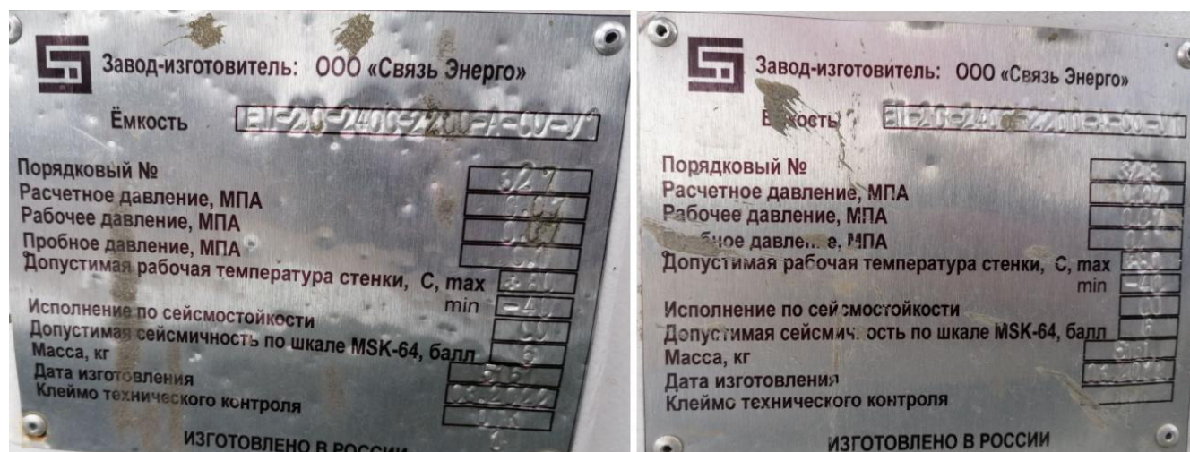
Рисунок 1 – Маркировочные таблички резервуаров
