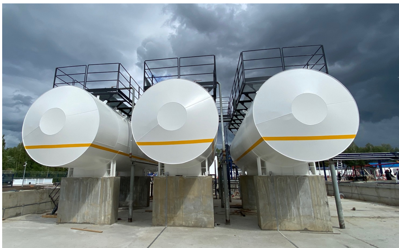
Рисунок 2 – Общий вид резервуаров РГСН 50
