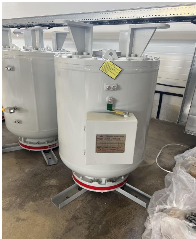
Рисунок 1 – Общий вид трансформаторов напряжения JDQXF-330.
