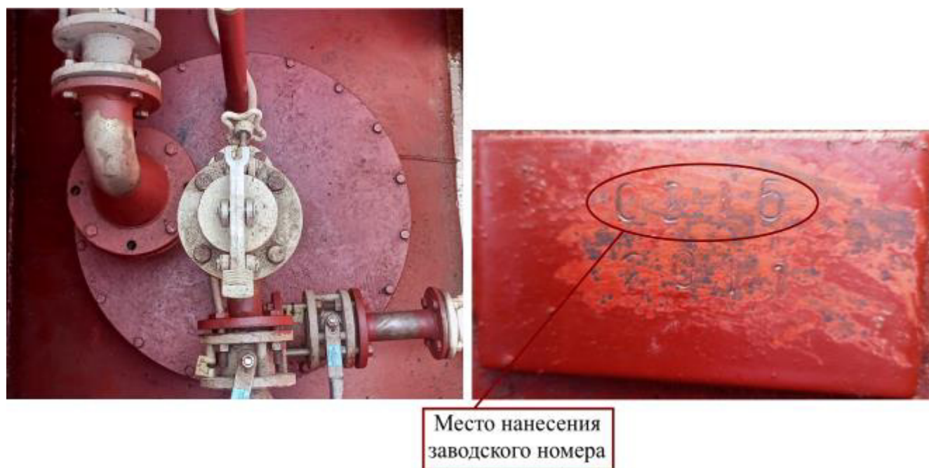
Рисунок 10 – Горловина и измерительный люк резервуара РГП 25-1-2(0,85)-О-У зав.№ 0215
