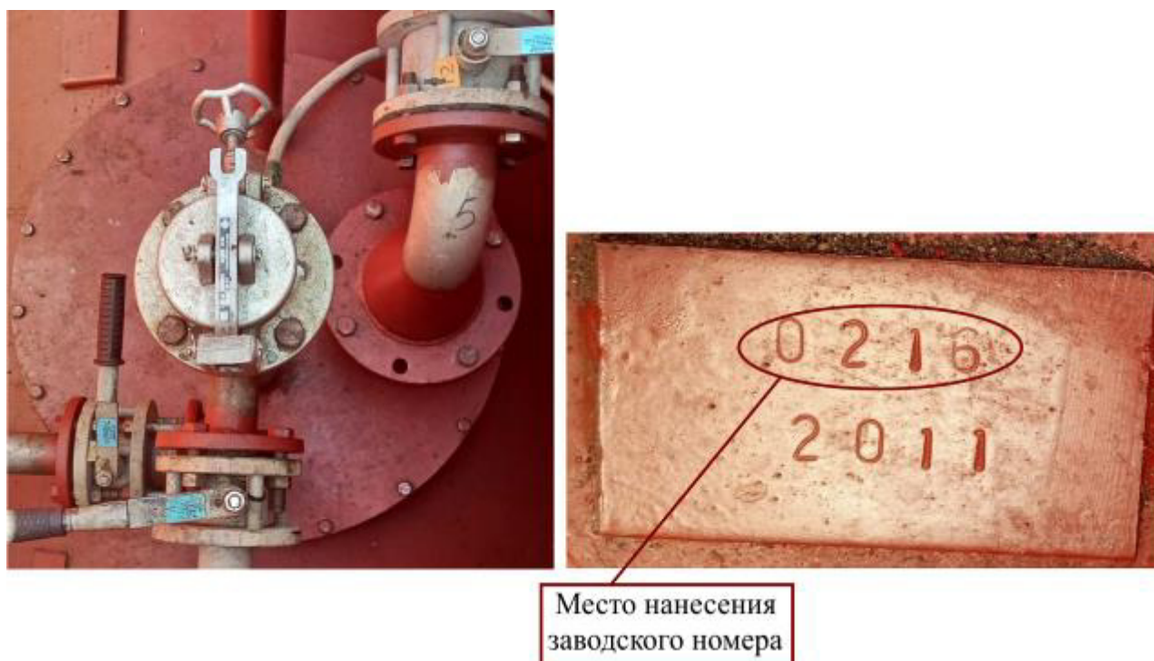
Рисунок 11 – Горловина и измерительный люк резервуара РГП 25-1-2(0,85)-О-У зав.№ 0216 Пломбирование резервуаров РГП 25-1-2(0,85)-О-У не предусмотрено.
