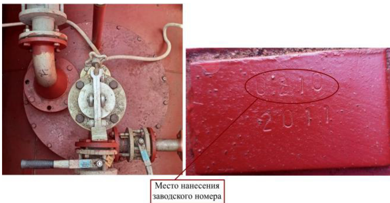
Рисунок 6 – Горловина и измерительный люк резервуара РГП 25-1-2(0,85)-О-У зав.№ 0210
