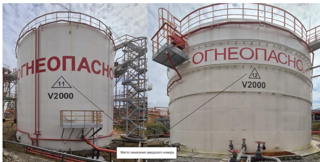
Рисунок 1 – Общий вид резервуаров вертикальных стальных цилиндрических РВСП-2000 с указанием места нанесения заводских номеров
