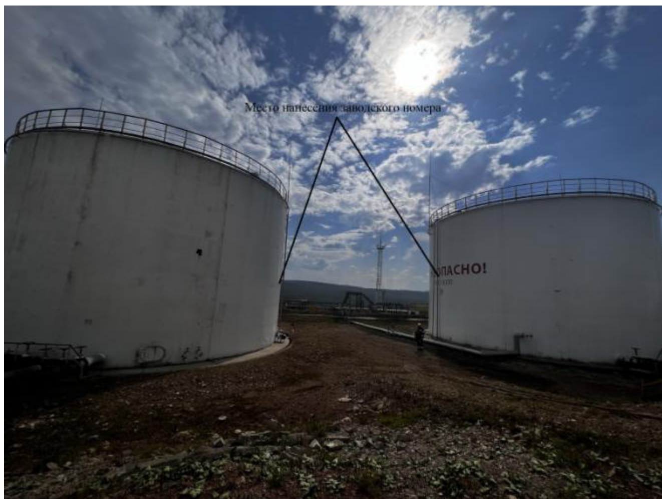
Рисунок 1 – Общий вид резервуаров вертикальных стальных цилиндрических РВС-3000 зав.№№ 9,10 с указанием места нанесения заводских номеров
