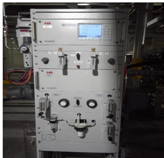
Рисунок 6 – Общий вид внутри шкафа системы
