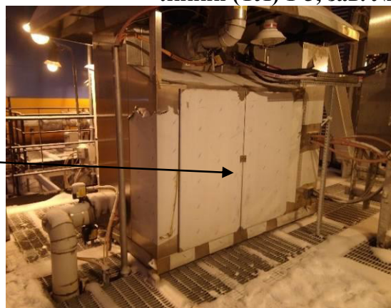
Рисунок 3 – Общий вид шкафа системы
