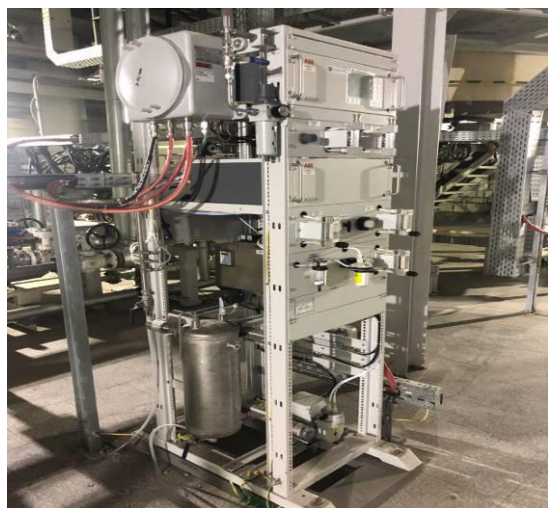
Рисунок 5 – Общий вид шкафа
