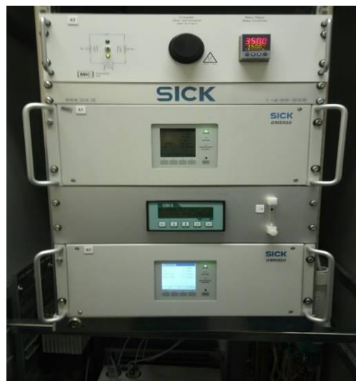
Рисунок 2 – Общий вид внутри контейнера системы
