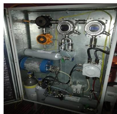
Рисунок 8 – Общий вид внутри шкафа системы
