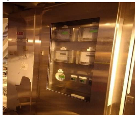
Рисунок 4 – Общий вид внутри шкафа системы
