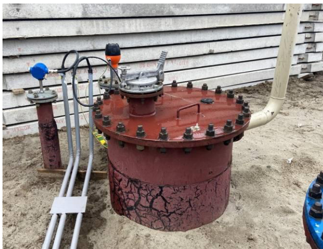
Рисунок 2 – Горловины и замерный люк резервуара стального горизонтального цилиндрического РГС-12,5, зав. № 881275471001.
