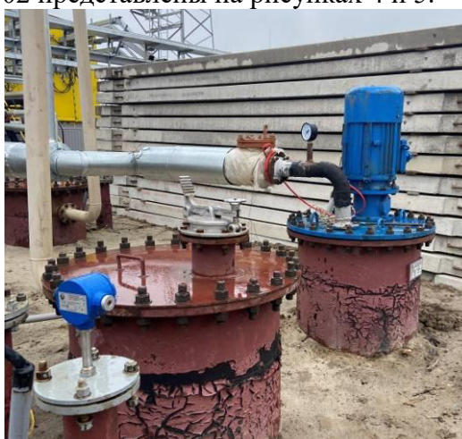
Рисунок 4 – Горловины и замерный люк резервуара стального горизонтального цилиндрического РГС-12,5, зав. № 881275471002.
