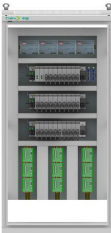
Рисунок 1 - Общий вид стойки модулей MAS400 в электротехническом шкафу
