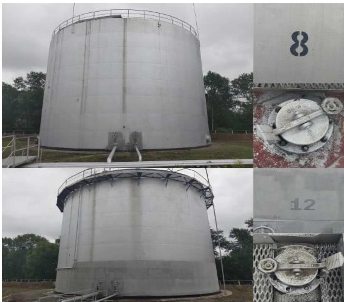
Рисунок 1 – Фотографии общего вида резервуаров стальных вертикальных цилиндрических РВС- 2000, горловин замерных люков и заводских номеров
