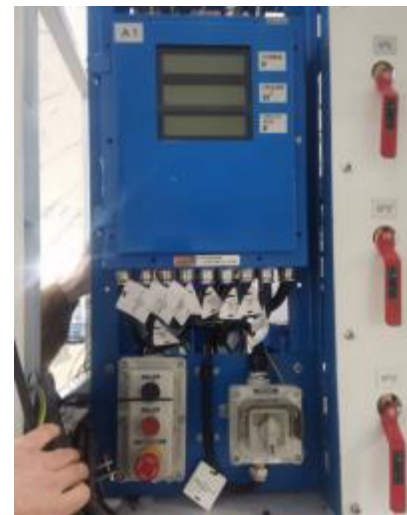
в составе передвижного автогазозаправщика
