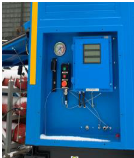
в составе модуля компримирования природного газа
