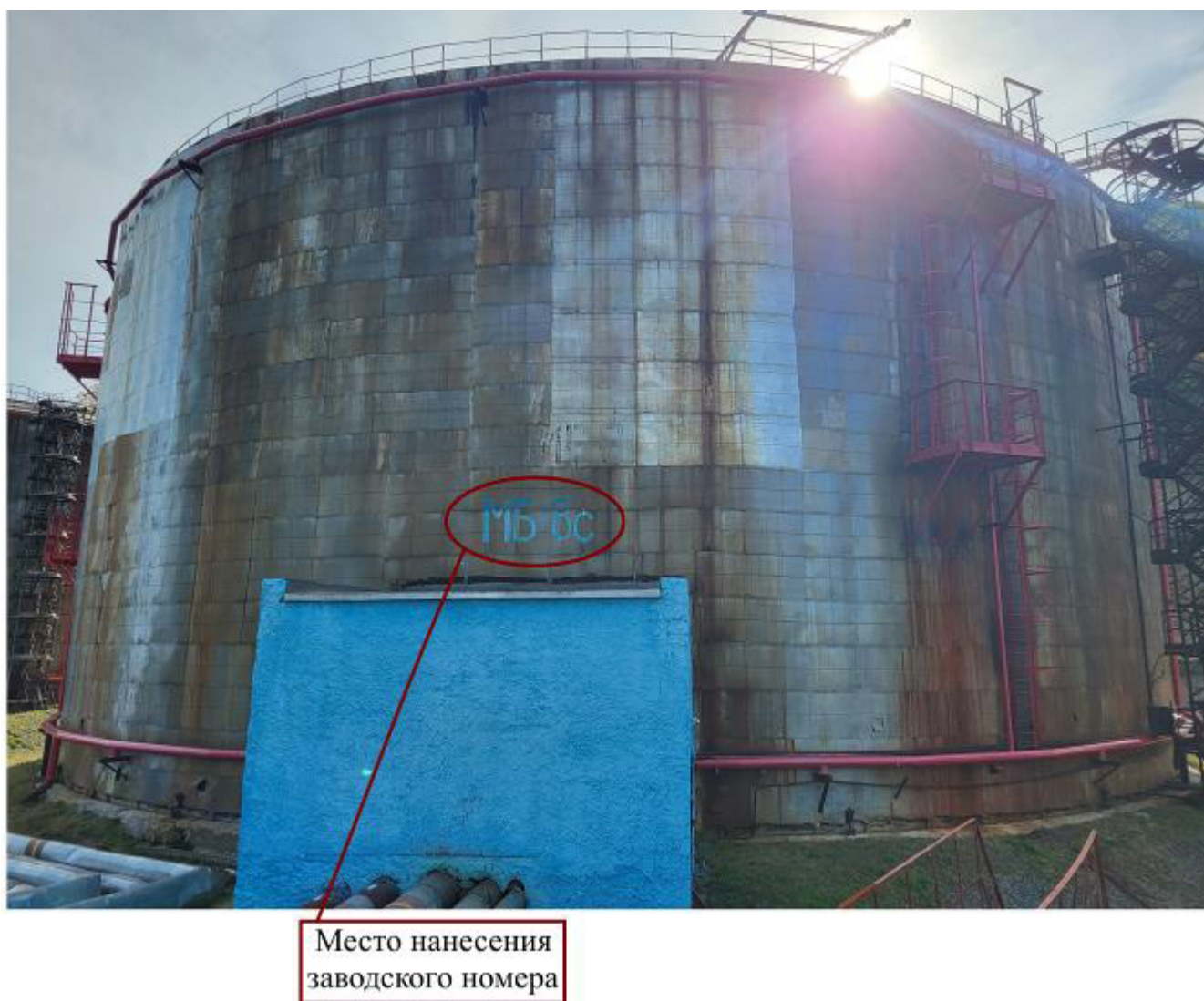
Рисунок 1 – Общий вид резервуара РВС-20000 зав.№ МБ-8с с указанием места нанесения заводского номера
