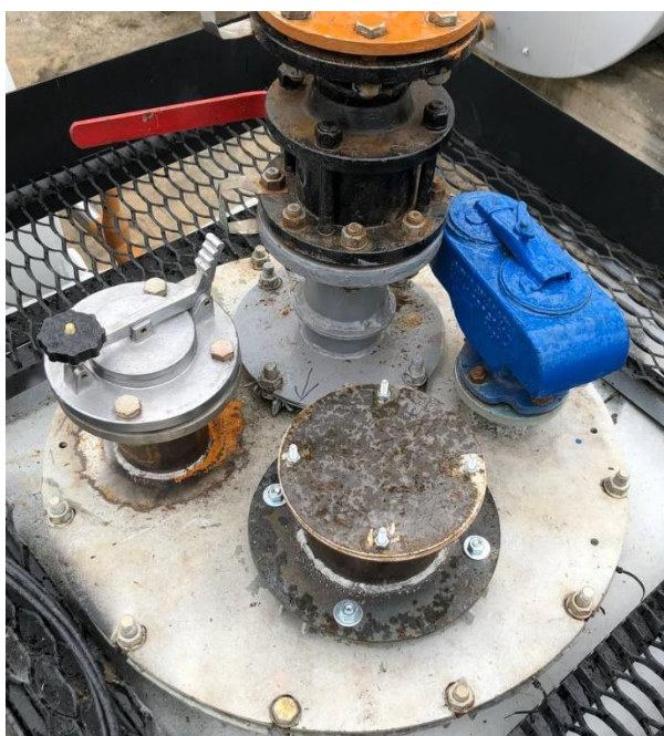
Рисунок 3 – Общий вид горловин и замерных люков резервуаров РГС-50
