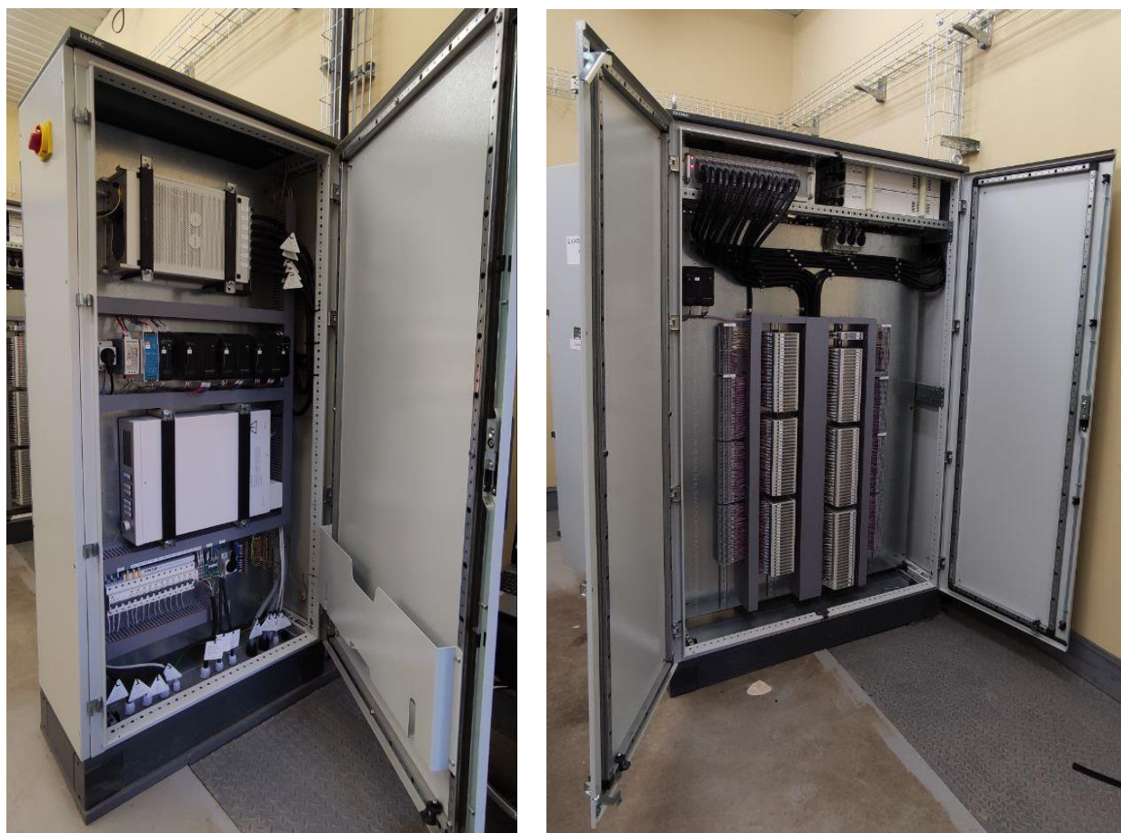
Рисунок 2 – Общий вид шкафов управления системы
