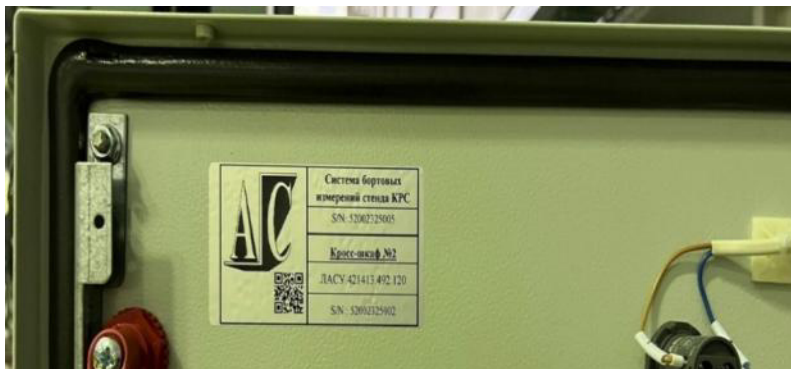
Рисунок 6 - Тыльная сторона дверцы кросс-шкафа 2 с заводским знаком
