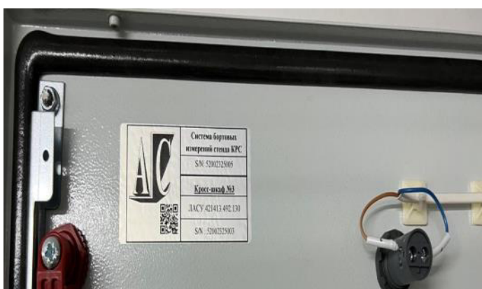
Рисунок 8 - Тыльная сторона дверцы кросс-шкафа 3 с заводским знаком
