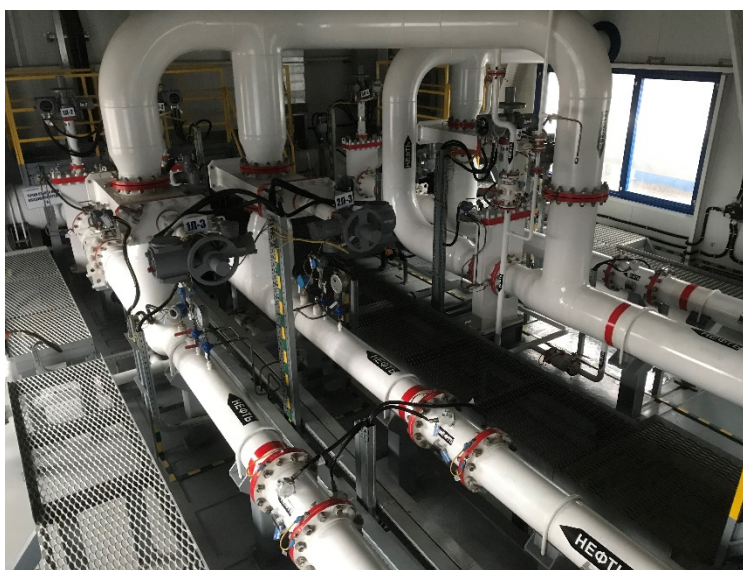
Рисунок 1 - Общий вид СИКН
