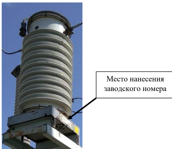
Рисунок 1 - Общий вид трансформаторов тока ТФЗМ 110Б-IV У1
