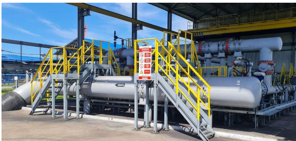
Рисунок 1 - Общий вид СИКН
