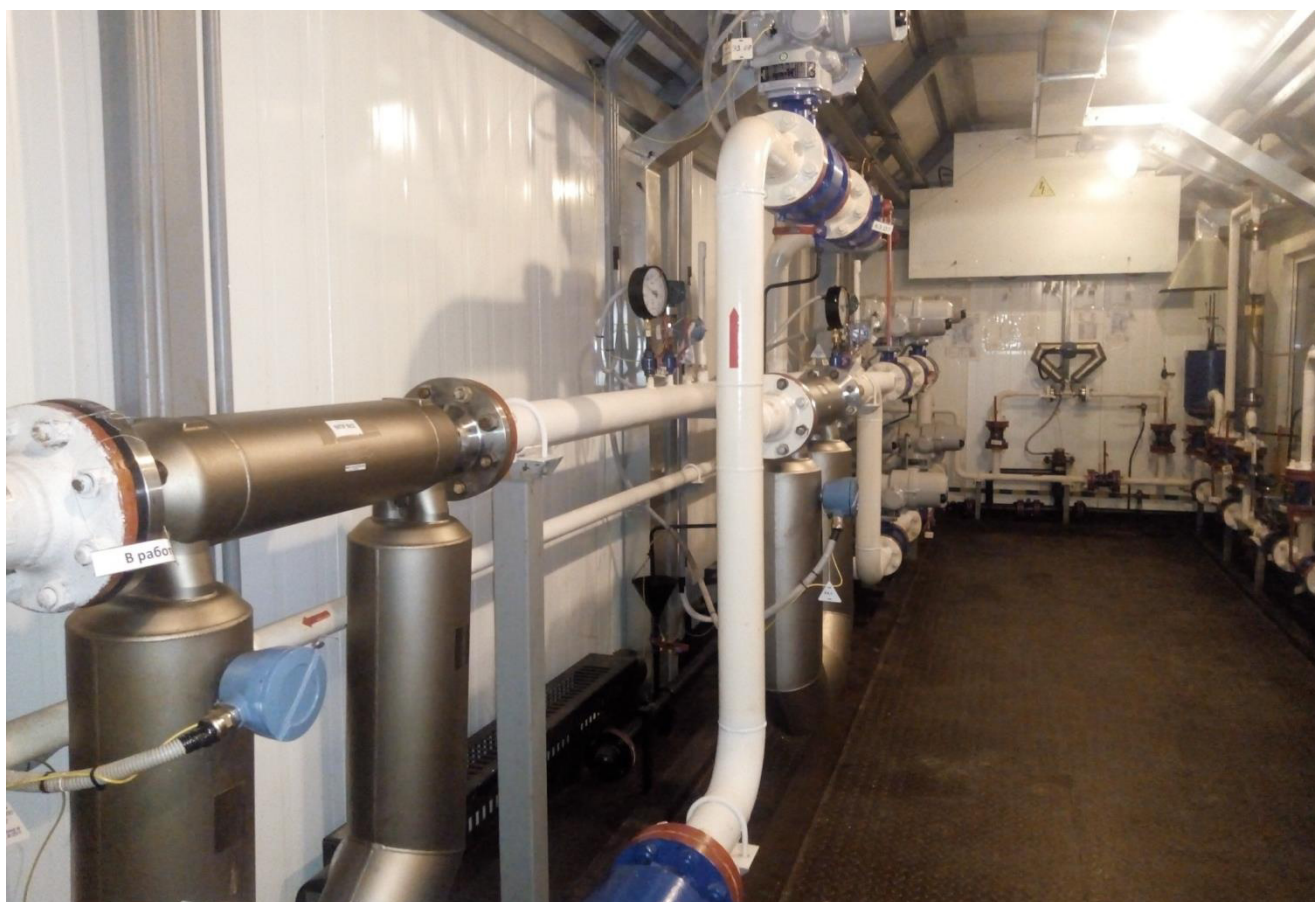
Рисунок 2 – Общий вид СИКН
