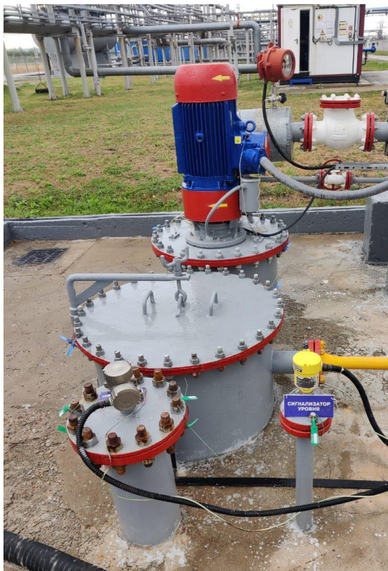
Рисунок 2 – Горловины и замерный люк резервуара.
