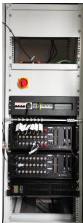
Рисунок 4 – Общий вид модульных систем сбора данных SIRIUS-R3-SYSTEM, установленных в шкаф
