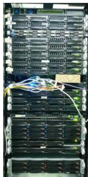
в) комплектный шкаф, с установленным в нем сервером ПТК и сервером синхронизации частоты и времени
