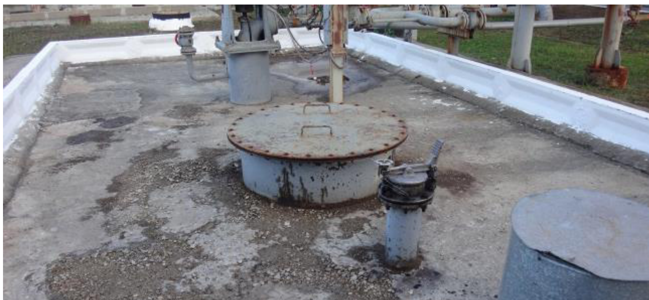
Рисунок 4 – Горловины и измерительный люк резервуара РГС-50 зав.№11Е-1
