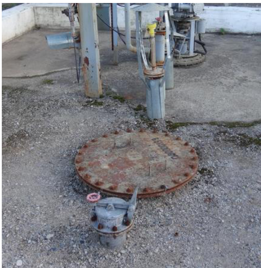
Рисунок 5 – Горловины и измерительный люк резервуара РГС-60 зав.№Е-5
