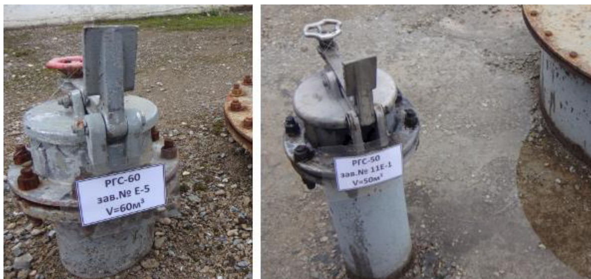
Рисунок 1 – Измерительные люки резервуаров
