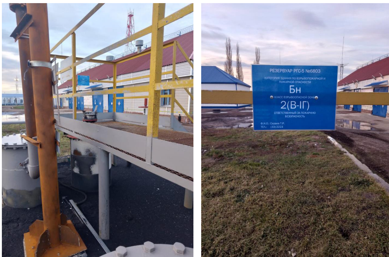
Рисунок 2 – Фотография маркировочной таблички, горловины и крышки замерного люка резервуара
