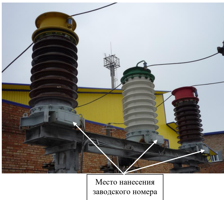
Рисунок 1 - Общий вид трансформаторов напряжения НКФ-110-57 У1
