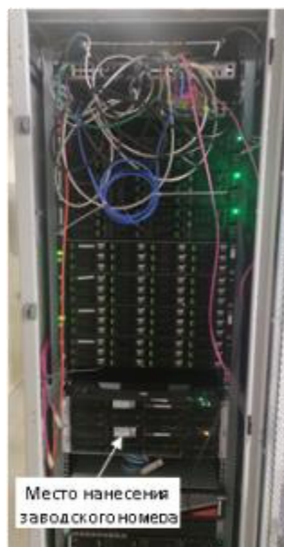
Рисунок 1 - Общий вид СБД ООО «РКС-энерго» АИИС КУЭ с указанием места нанесения заводского номера.
