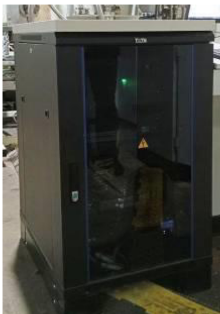
Рисунок 1 - Шкаф информационно-измерительной системы (ШИИС)
