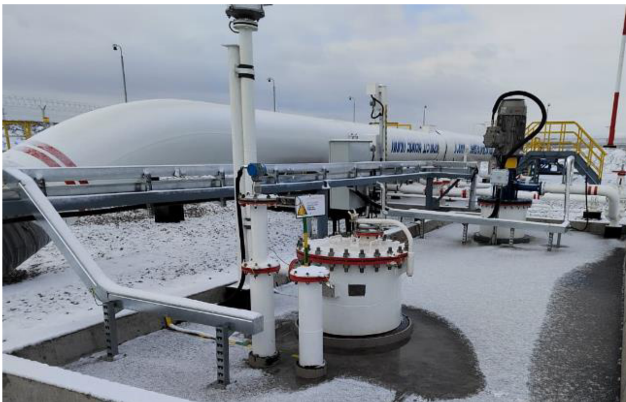
Рисунок 3 – Горловины и измерительный люк резервуара ЕП-40-550-А-СО-У1 зав.№ 59346
