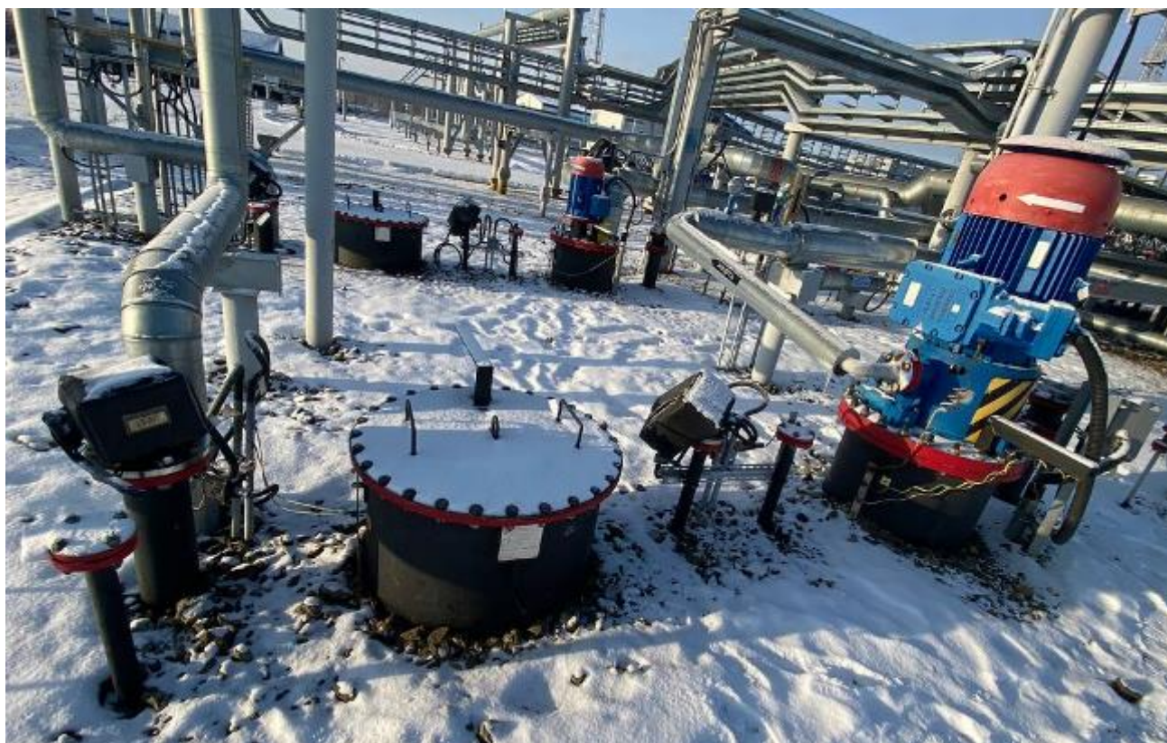
Рисунок 2 – Горловины и измерительный люк резервуара ЕП-16-2000-1300 зав.№ 607
