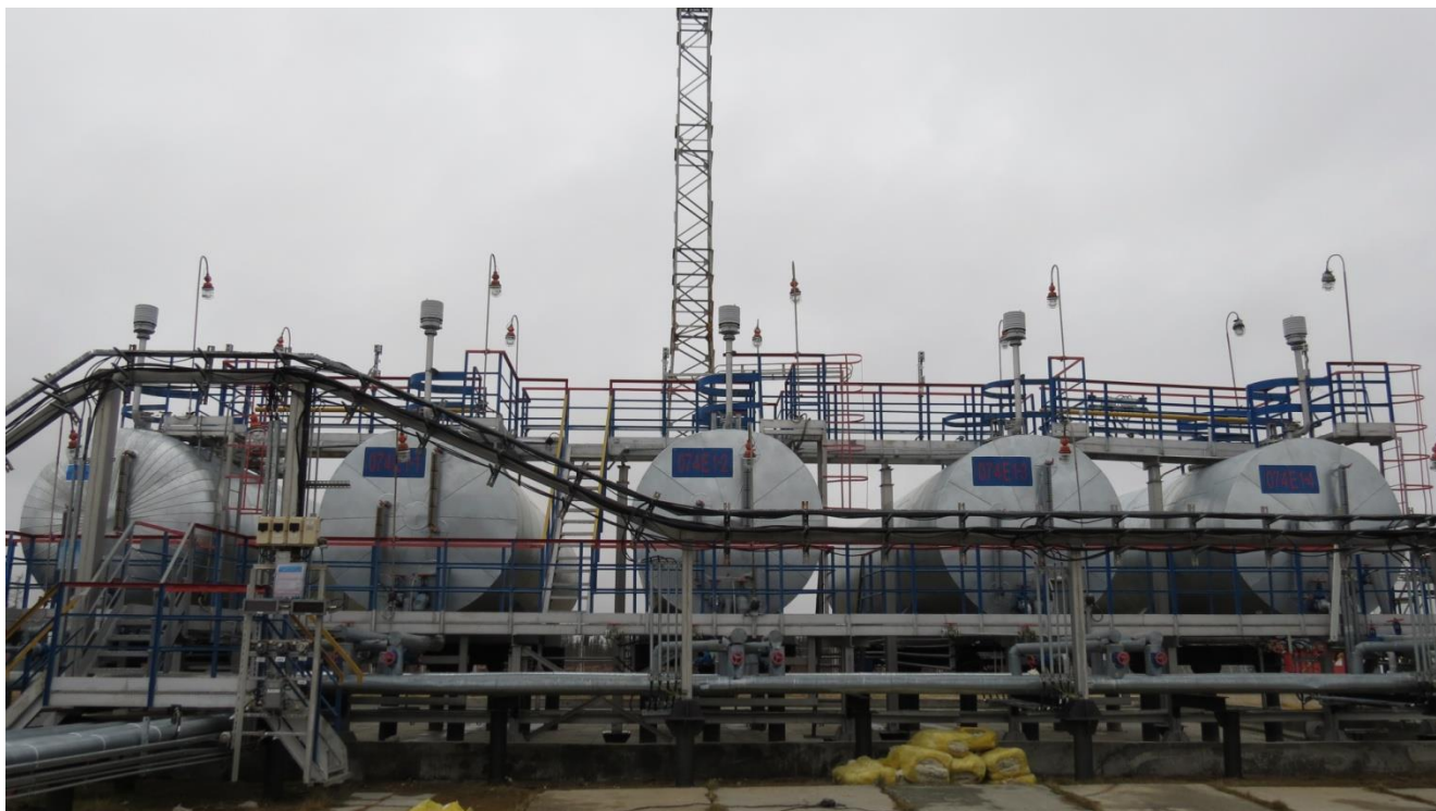
Рисунок 1 – Общий вид резервуаров стальных горизонтальных цилиндрических РГС-100
